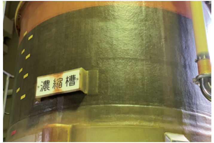
限外ろ過膜を使用した濃縮槽。
