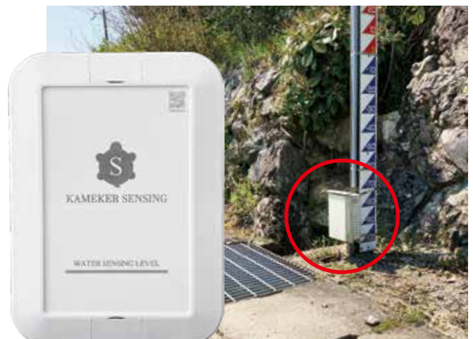
センサー本体(左画像)と外装ボックス(赤マル印)に入れての設置
