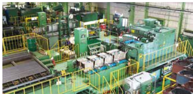
工場に設置された熱間フォーマー
