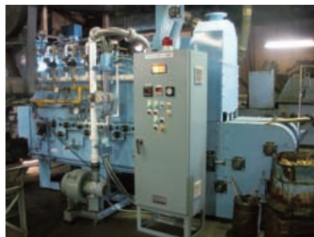
▲今回導入した全自動都市ガス炉
