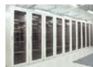
KRPPデータセンター 24時間安心のセキュリティ。最高の環境でお預かりいたします。
